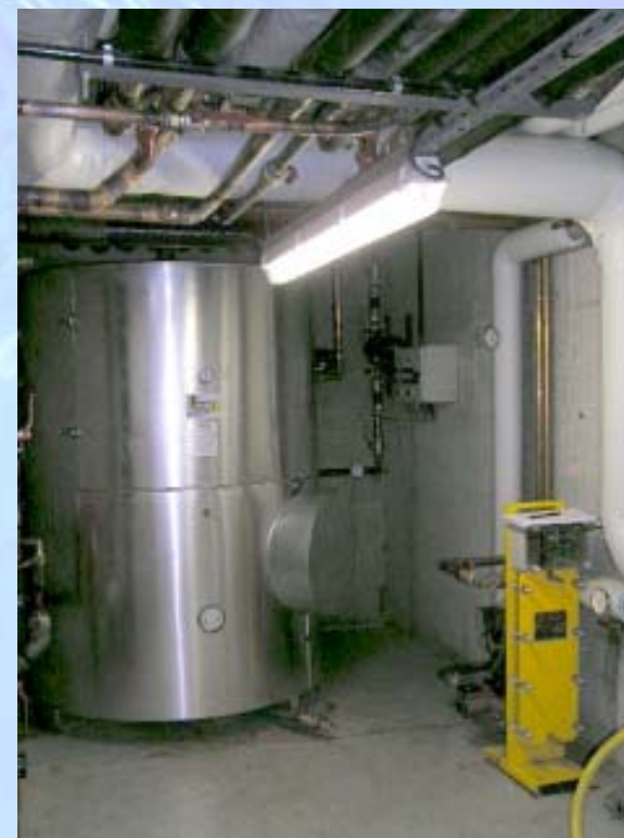
Echangeur à plaques et ballon de stockage
